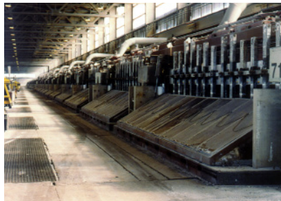
Elektrolysehalle in Essen der TRIMET ALUMINIUM AG
