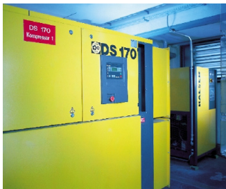
Kompressor zur Druckluftherzeugung
