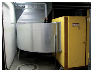
Nutzung der Kompressorenabwärme bei DIEHL
