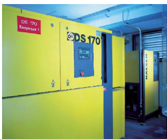
Kompressor zur Druckluftherzeugung
