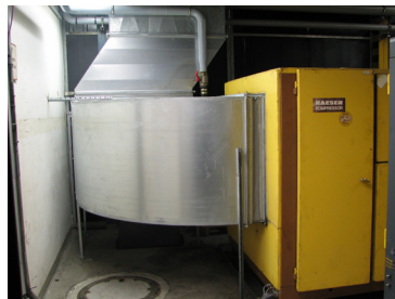
Nutzung der Kompressorenabwärme bei DIEHL
