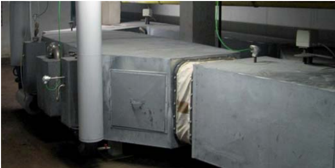
Luft-Wasser-Wärmetauscher zur Nutzung der Restwärme aus Verbrennungsabgasen in einem WIEGEL-Werk
